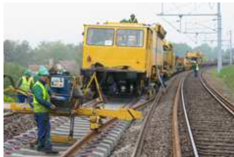
Longs Rails soudés sur traverses béton
