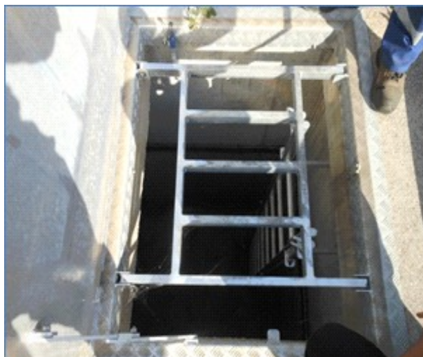
Accès à l'intérieur de la chambre d'un ouvrage d'eau potable par un trou d'homme protégé par une plaque métallique, dont l'ouverture est équipée d'un détecteur d'intrusion
