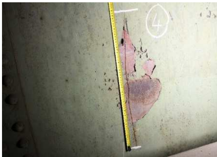
Photo de la fissure de 60 cm
